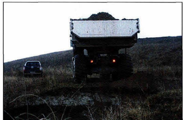
Verfüllung der Versackung aus Sicherheitsgründen ( Bild 3 )
