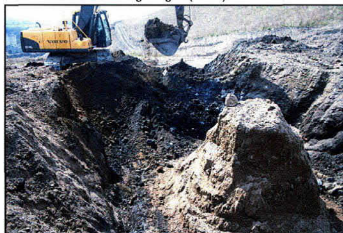
Freigelegte Versackung, die eingebrachte Feinabsiebung ist als Negativform der Versackung sichtbar (Bild 5)
