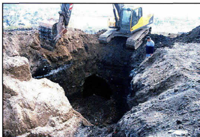
Freigelegte Wasserwegsamkeiten der Versackung (Bild 6)
